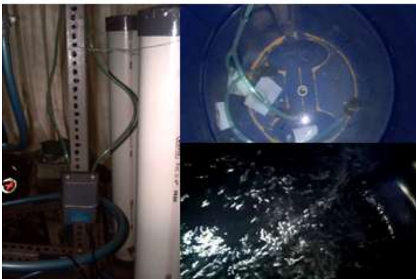
Gambar 11. Proses aerasi pada saringan pasir lambat
